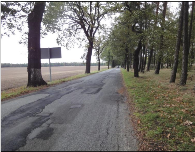
Bild 1: Schadensbild der Straße vor Sanierung
